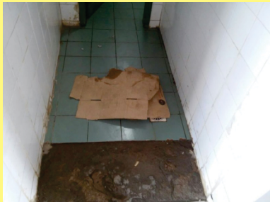
O banheiro da Escola Municipal Maria Diva Matos Portela funciona em condições precárias.
