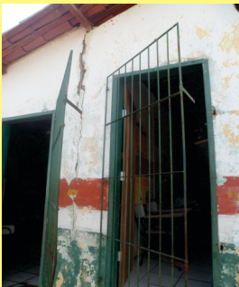
A Escola Municipal Florêncio Ferreira Santos, em Bonfim de Feira, funciona com paredes do prédio rachadas.
