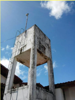
Com estrutura ameaçada, o reservatório de água da Escola Municipal Maria Diva Matos Portela está impossibilitado de ser limpo. A comunidade escolar tem consumido água sem as devidas condições.
